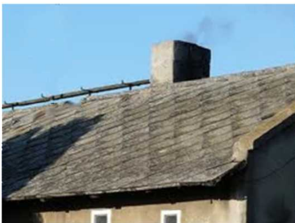
Rys. 3. Płyta azbestowo-cementowa karo
