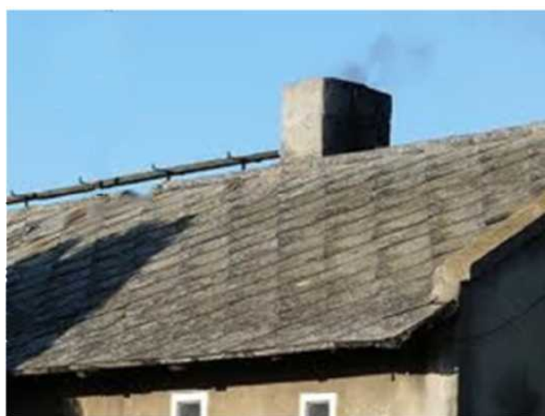
Rys. 3. Płyta azbestowo-cementowa karo
