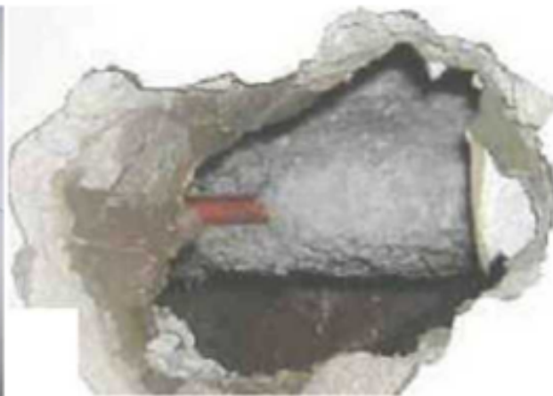
Rys. 6. Azbestowa izolacja rury
