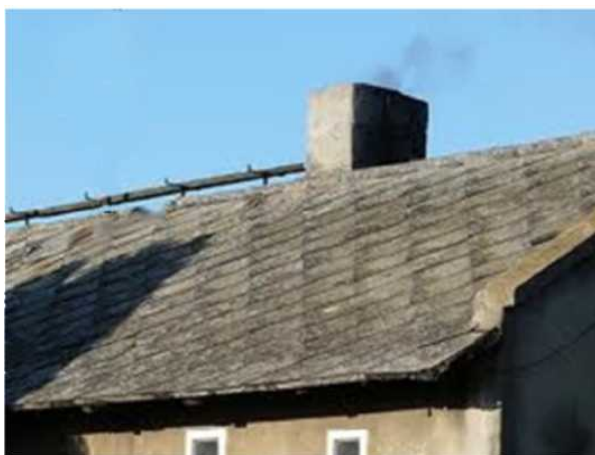
Rys. 3. Płyta azbestowo-cementowa karo
