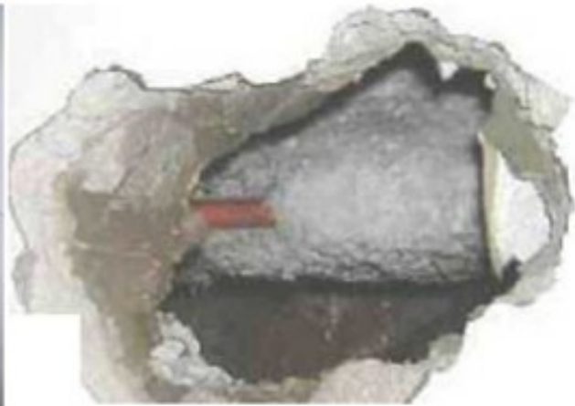
Rys. 6. Azbestowa izolacja rury
